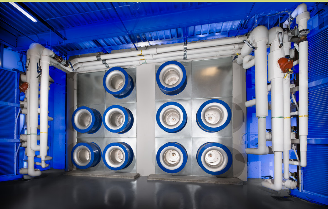
Fan Room Inlet
