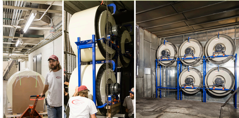
▲ AcoustiFLO Fan Installation
